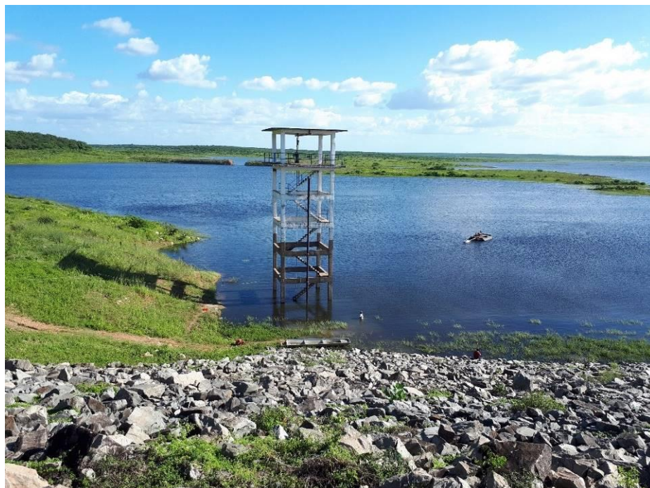
Figura 2 – Tomada d'água do Açude Sítios Novos.
