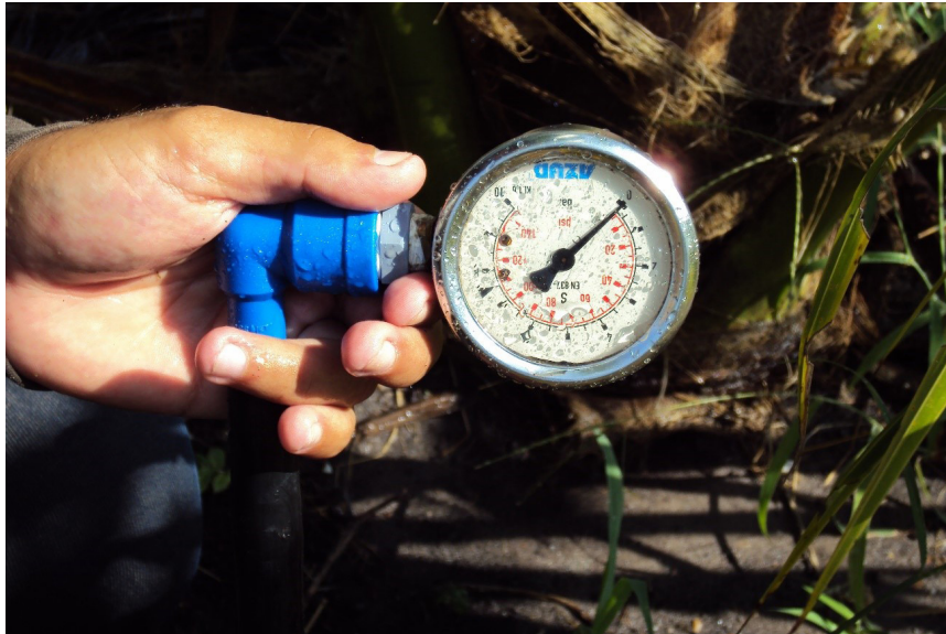
Figura 6 - Verificação da pressão com o auxílio de um manômetro no final de linha de distribuição em sistema de irrigação localizado para identificar se a pressão apresenta uma variação aceitável desde o cavalete
